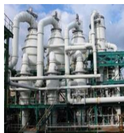
【立釜】※複数の釜を連結して排熱再利用
